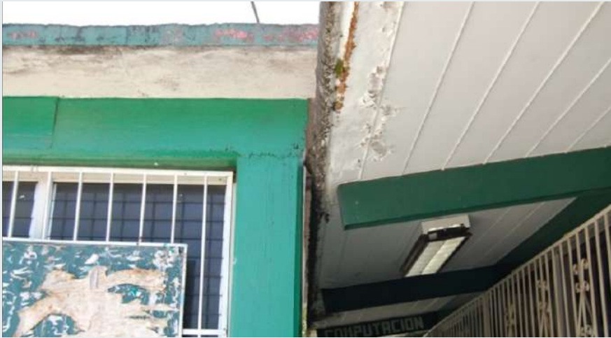
Figura 1.6.4 Edificios en contacto vulnerables a golpeteo. Fuente: cortesía del INIFED (2019b).
