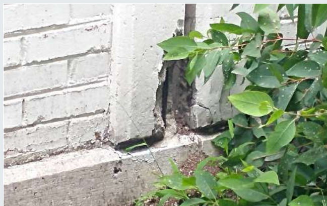
Figura 1.6.27 Corrosión del acero de refuerzo vertical en bardas perimetrales. Fuente: cortesía del INIFED (2019b).
