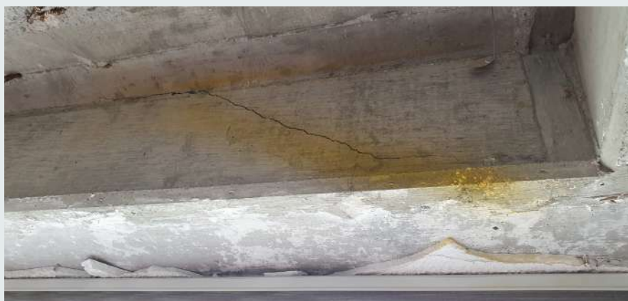
Figura 6.3.1 Identificación y descubrimiento de la grieta de acabados adyacentes. Fuente: archivo personal de Rubén Bautista (2019).
