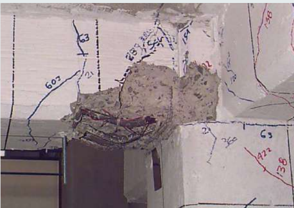
Figura 1.6.6 Falla por flexión y agrietamiento por tensión diagonal de una viga de concreto, con pandeo del refuerzo longitudinal. Fuente: CENAPRED (2019).
