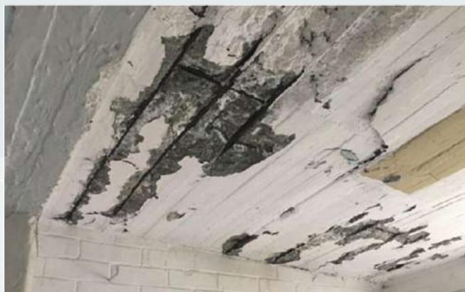
Figura 1.6.26 Desprendimiento de concreto en losas debido a corrosión del acero de refuerzo. Fuente: cortesía del INIFED (2019b).
