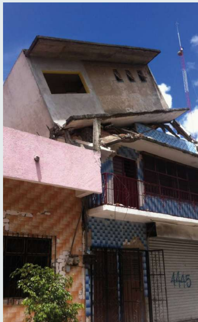
Figura 4.2.6 Ejemplo de peligro de un edificio adyacente. Fuente: Archundia et al. (2018).
