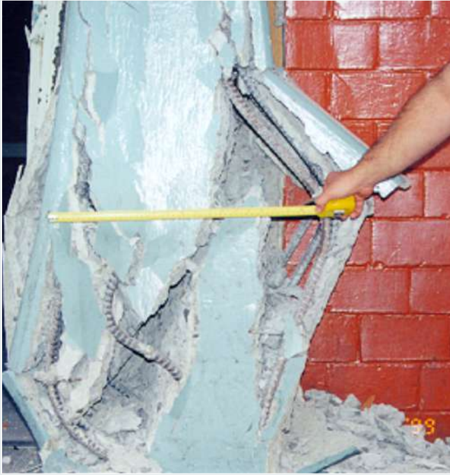
Figura 1.6.10 Falla por flexión-tensión diagonal y posterior aplastamiento del concreto en columna. Fuente: archivo personal de Sergio Alcocer (1999).
