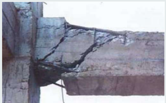
Figura 1.6.7 Falla por tensión diagonal pura en viga de concreto. Fuente: Instituto Valenciano de la Edificación (2019).
