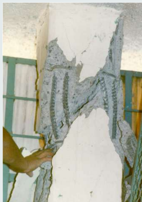
Figura 1.6.12 Falla por tensión diagonal en columnas cortas de marcos de concreto. Fuente: cortesía del INIFED (2019b).
