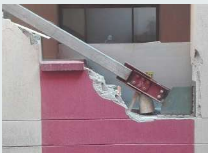
e) Disipadores de fricción
