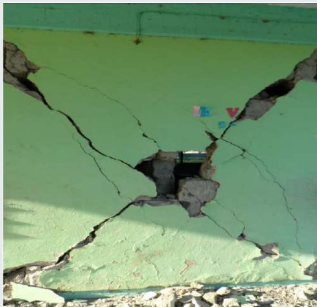
Figura 1.6.17 Falla por tensión diagonal en muros de mampostería. Fuente: cortesía del INIFED (2019b).
