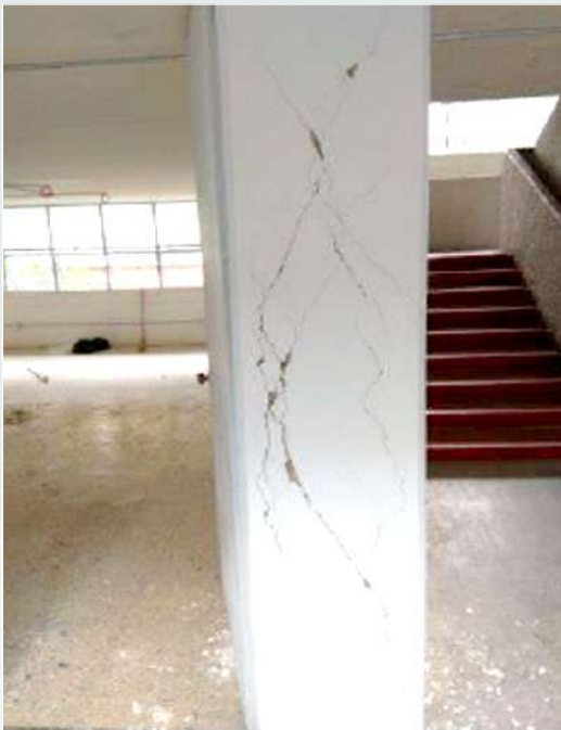
Figura 1.6.11 Agrietamiento por tensión diagonal en columna de concreto. Fuente: cortesía del INIFED (2019b).
