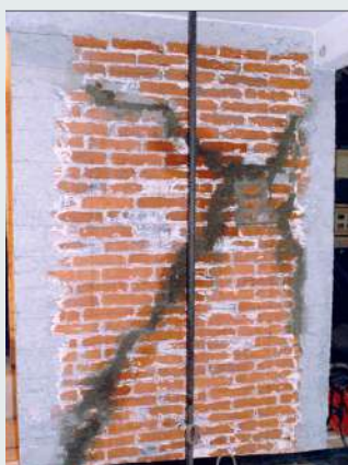
Figura 6.9.8 Reparación de grietas por rajueleo. Fuente: archivo personal de Sergio Alcocer (1994).
