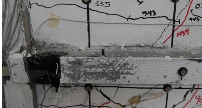
Fig. 3.3.127 Agrietamiento del grout en la solera intermedia - Columna C-2 (Instituto de Ingeniería, 2021 - 2023)
