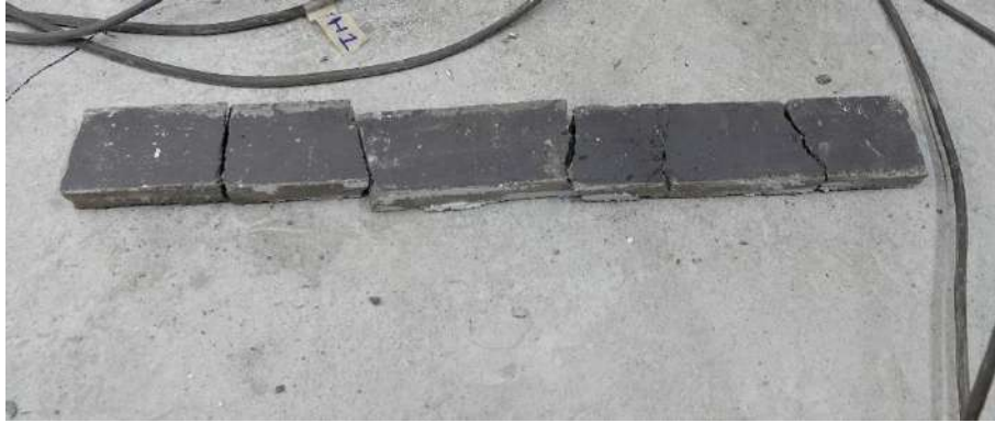
Fig. 3.3.141 Grout desprendido - Columna C-2 (Instituto de Ingeniería, 2021 - 2023)
