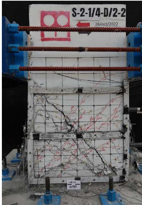
Fig. 3.3.143 Cara norte ( R=-4\% ) - Columna C-2 (Instituto de Ingeniería, 2021 - 2023)
