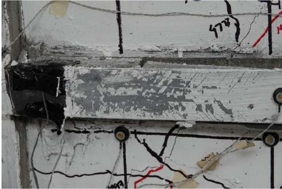
Fig. 3.3.134 Desprendimiento de pintura a base de cal - Columna C-2 (Instituto de Ingeniería, 2021 - 2023)
