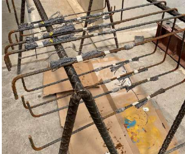
Fig. 2.5.9 Estribos instrumentados (Instituto de Ingeniería, 2021 - 2023)
