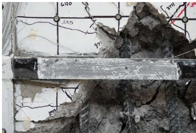
Fig. 3.3.166 Detalle en solera y acero expuesto - Columna C-2 (Instituto de Ingeniería, 2021 - 2023)
