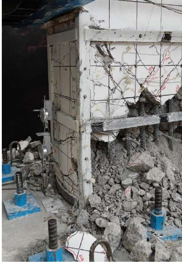
Fig. 3.3.171 Estado final del daño noroeste - Columna C-2 (Instituto de Ingeniería, 2021 - 2023)
