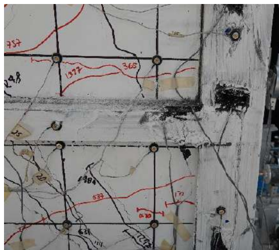
Fig. 3.3.192 . Desprendimiento de la pintura a base de cal ( R=-2.5\% ) - Columna C-4 (Instituto de Ingeniería, 2021 - 2023)
