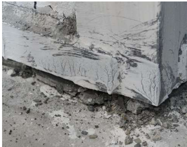
Fig. 3.3.194 Aplastamiento de la columna (R=3%) - Columna C-4 (Instituto de Ingeniería, 2021 - 2023)
