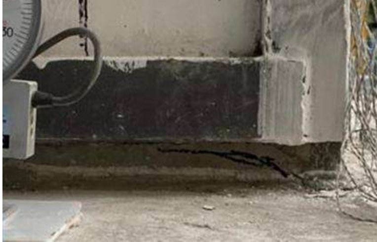
Fig. 3.3.113 Agrietamiento en la base de la columna - Columna C-2 (Instituto de Ingeniería, 2021 - 2023)
