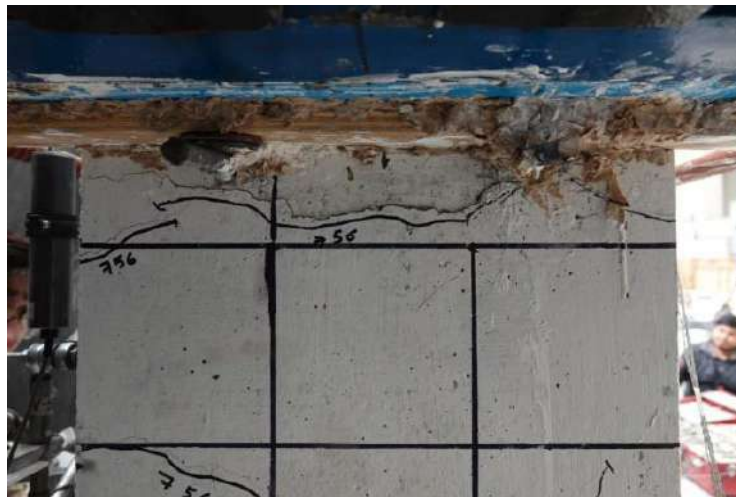
Fig. 3.3.74 Daño en cara este - Columna O* (Instituto de Ingeniería, 2021 - 2023)
