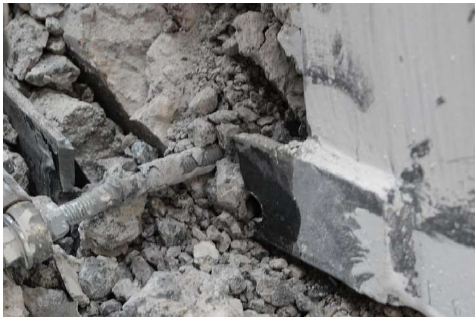
Fig. 3.3.208 Solera fracturada - Columna C-4 (Instituto de Ingeniería, 2021 - 2023)
