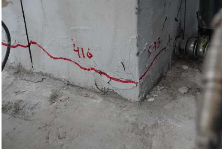
Fig. 3.3.75 Desconchamiento de concreto en la base - Columna O* (Instituto de Ingeniería, 2021 - 2023)
