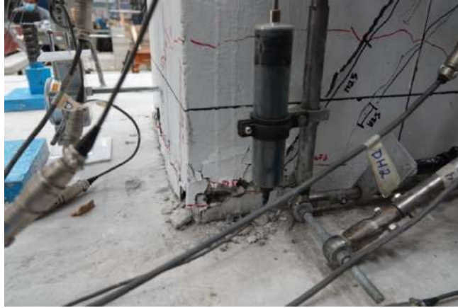
Fig. 3.3.81 Daño en la base de la columna - Columna O* (Instituto de Ingeniería, 2021 - 2023)
