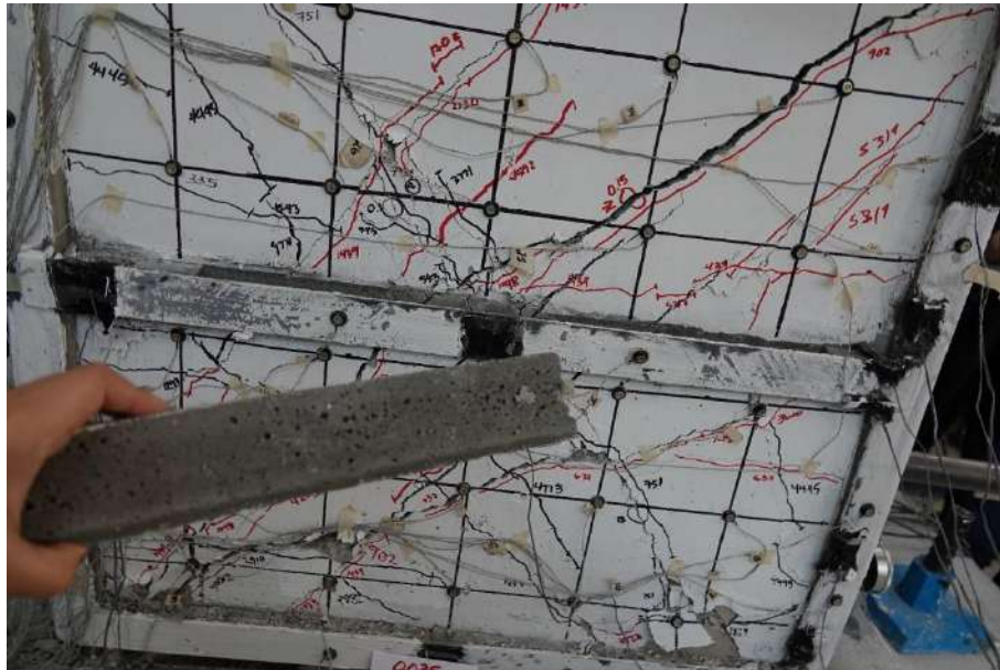
Fig. 3.3.140 Desprendimiento de grout en cara norte - Columna C-2 (Instituto de Ingeniería, 2021 - 2023)
