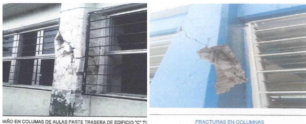
Figura 3.23 - Efecto de columna cortas en escuelas de concreto.
