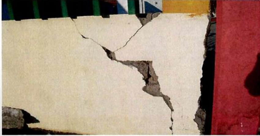
Figura 3.30 - Agrietamiento en el plano de bardas perimetrales.
