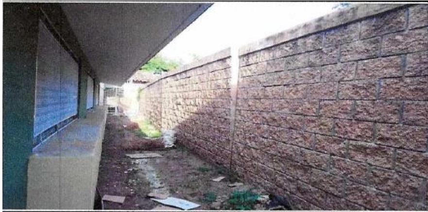
Figura 3.28 - Falla de bardas perimetrales por desplomo o inclinación.
